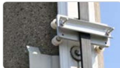
Connexion électrique permanente des projecteurs. Déplacement des câbles avec la structure
